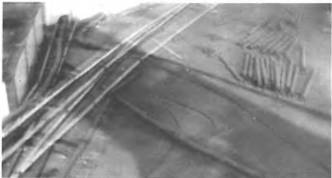
Kop. Sudamdih – rurociągi wodne z rzeki do szybów
